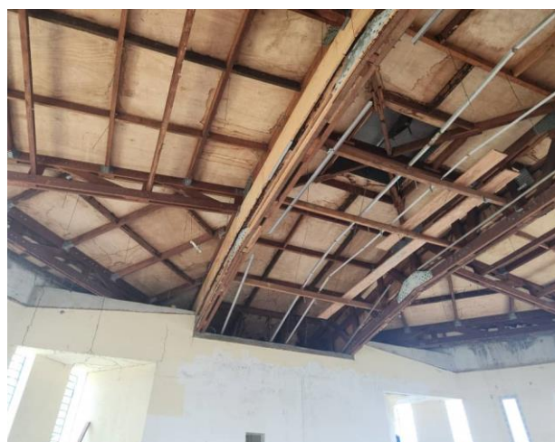
Photos ARMP : Vue de l'état de dégradation de l'Amphithéâtre du bâtiment de Génie Civil
