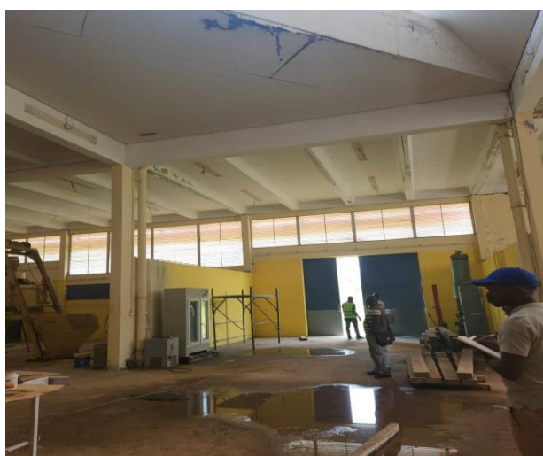
Photos ARMP : Vue des flaques d'eau dans la salle de Génie Mécanique
