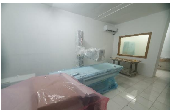
Vue de la salle de radiologie équipée
