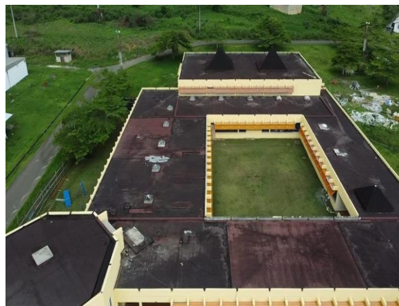
Etat de dégradation de la toiture du bâtiment de l'Institut National des Sciences Agronomiques et Biologie (INSAB)
